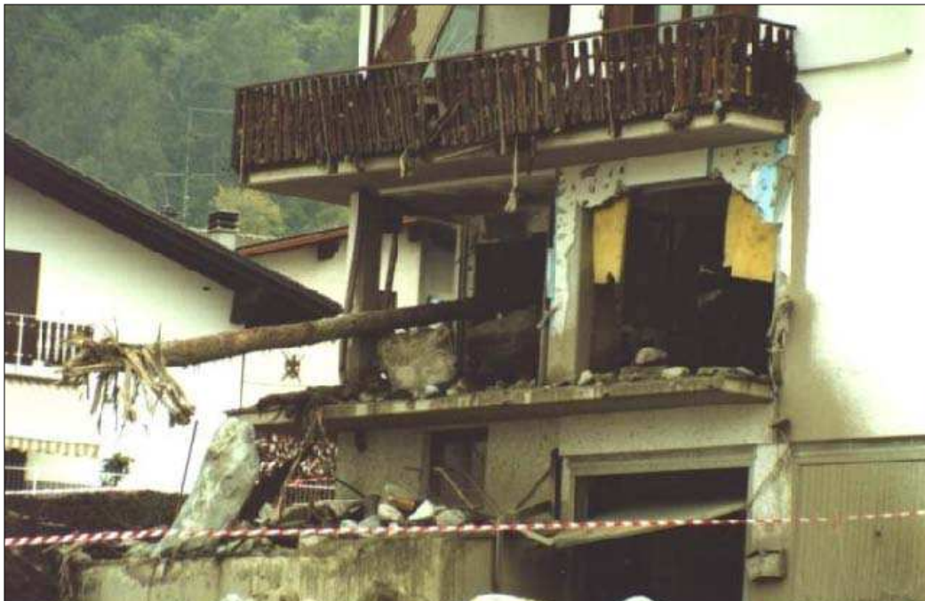
Effetto di colata detritica ad alta energia su edificio d'abitazione
