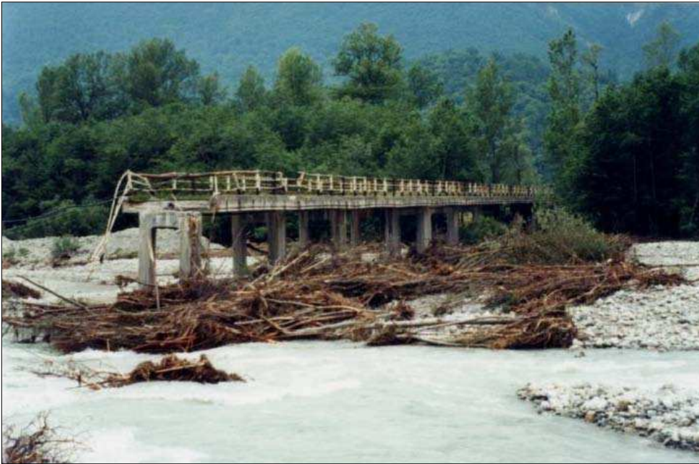
Tronchi convogliati a ridosso delle pile di un'opera di attraversamento
