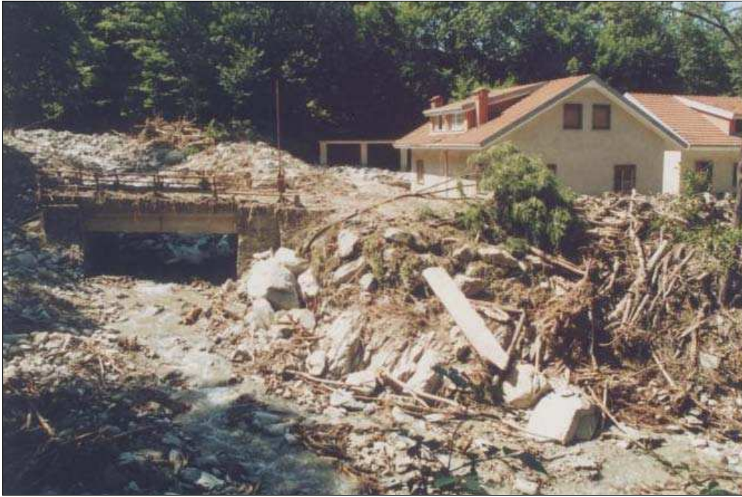
Accumulo forzato di detriti lapidei e vegetali per strettoia artificiale
