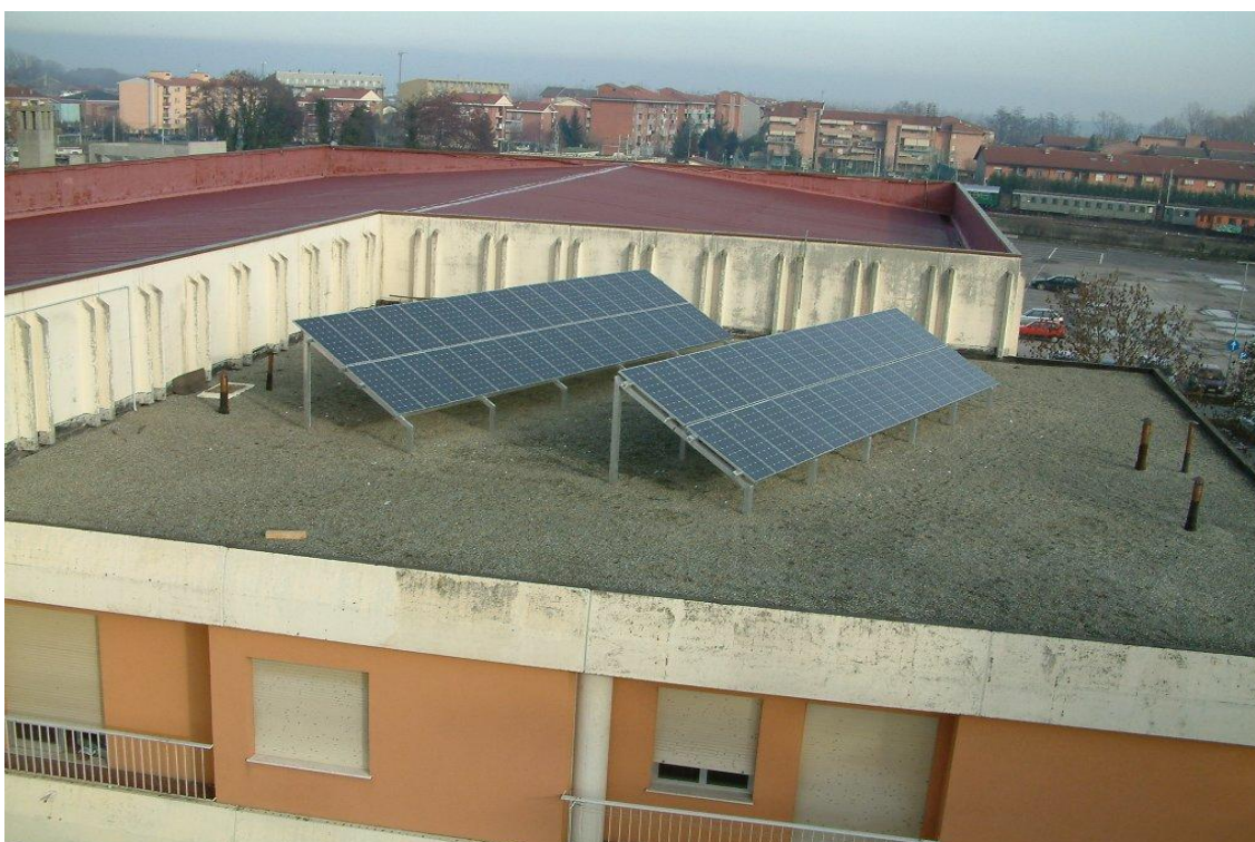
Figura 31. Impianto fotovoltaico Palazzetto dello sport, vicolo Arciretto - Savigliano
