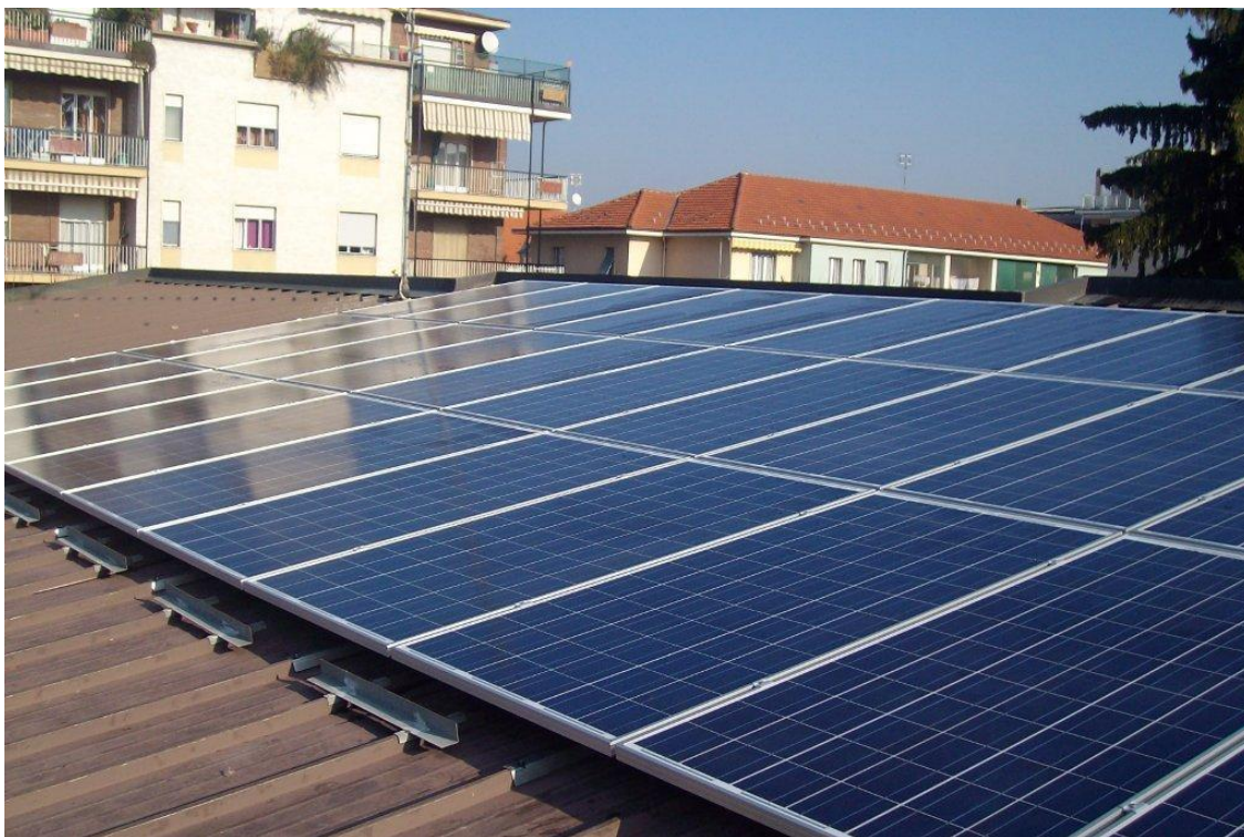
Figura 32. Impianto fotovoltaico Asilo Nido - Savigliano
